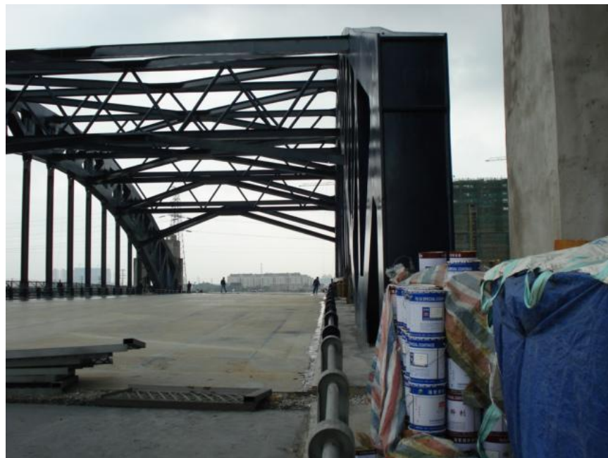
苏州悉尼大桥钢结构防腐 Антикоррозионная обработка стальной конструкции моста Сини в Сучжоу
